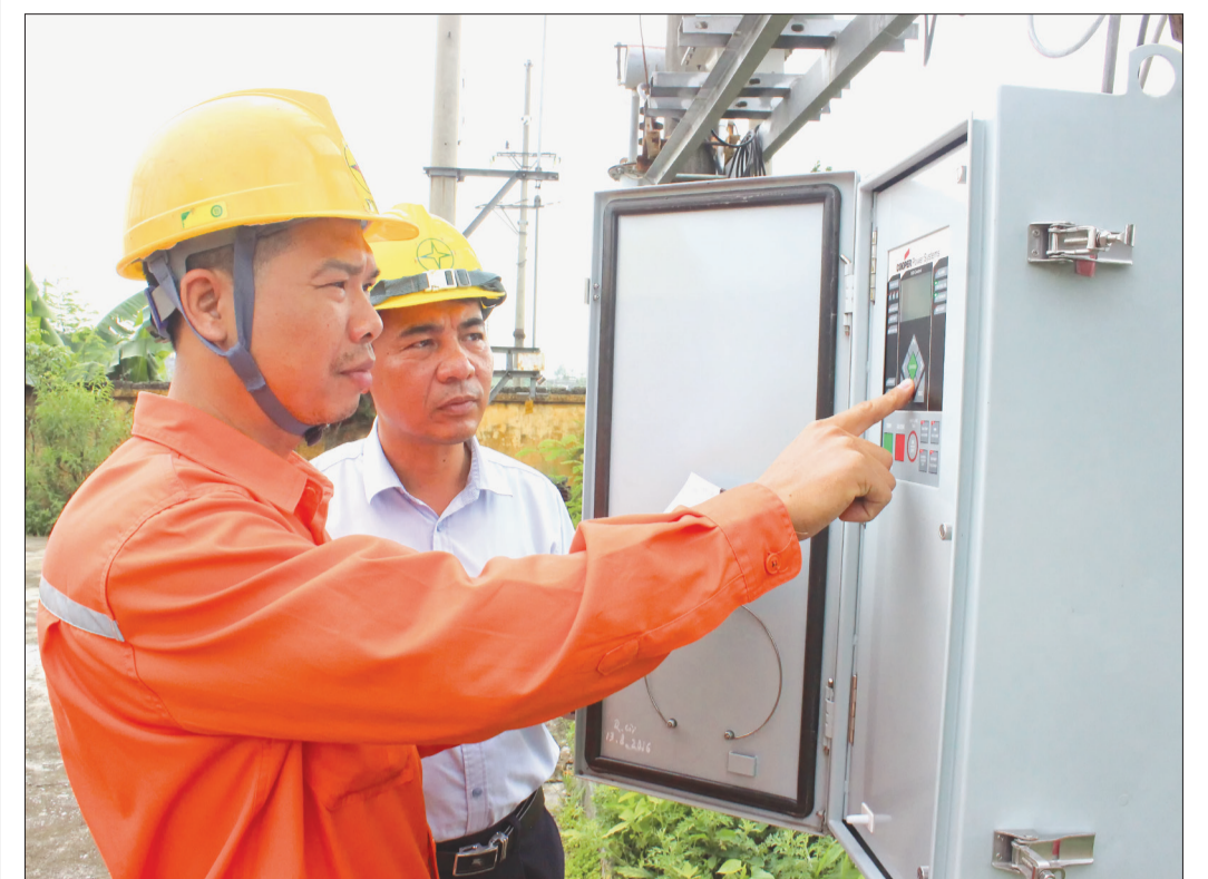
Công nhân ngành điện kiểm tra hệ thống thiết bị bảo đảm cung cấp điện ổn định, an toàn.
