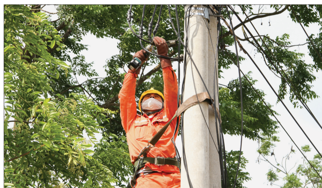
Nhân viên Điện lực Quỳnh Phụ kiểm tra đường dây bảo đảm cấp điện ổn định mùa nắng nóng.
