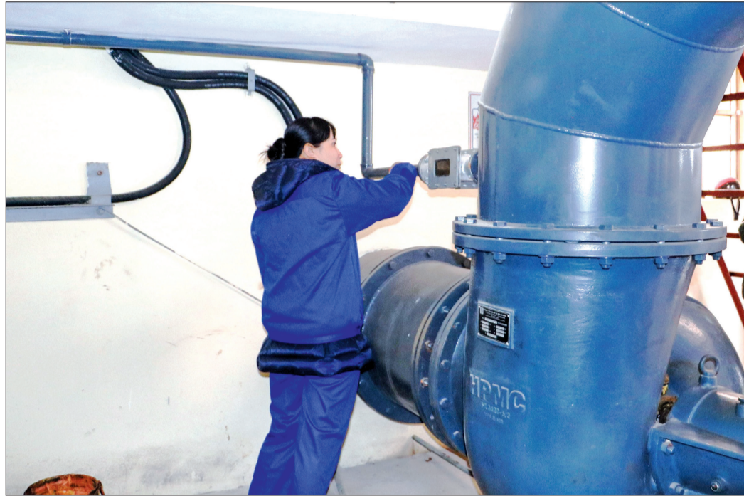
Đến nay, Công ty TNHH MTV Khai thác công trình thủy lợi Nam Thái Bình đã cơ bản hoàn thành bảo dưỡng, sửa chữa thường xuyên các công trình.
