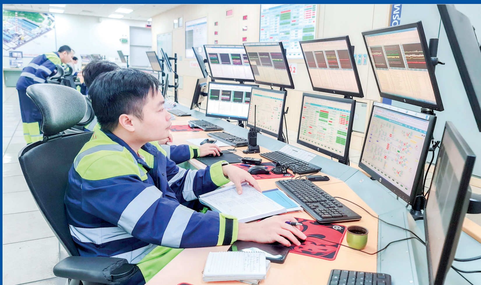
Các kỹ sư vận hành Nhà máy nhiệt điện Thái Bình 2.
