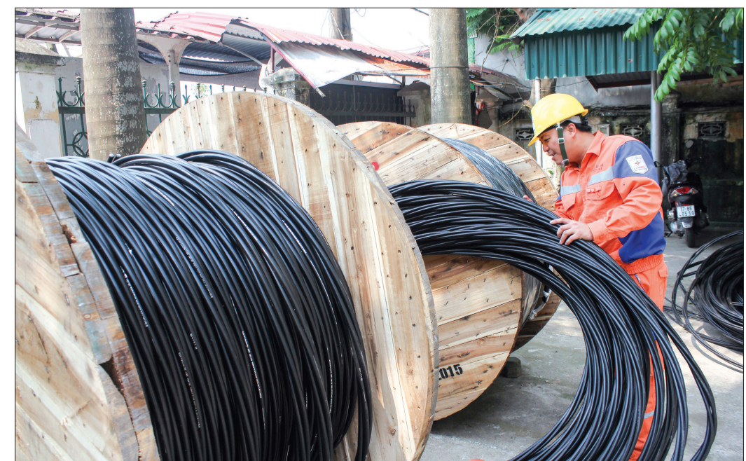
Điện lực Thái Thụy chuẩn bị vật tư để xử lý sự cố lưới điện.
