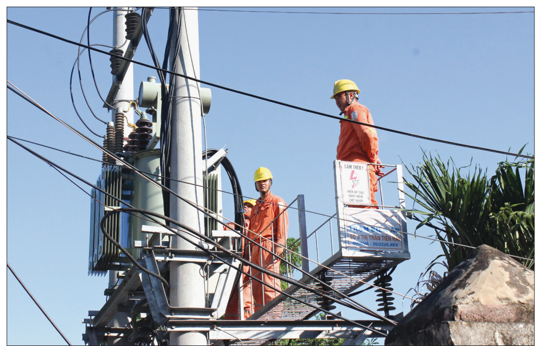
Công nhân Điện lực Tiền Hải kiểm tra trạm biến áp, bảo đảm cấp điện an toàn, ổn định.
