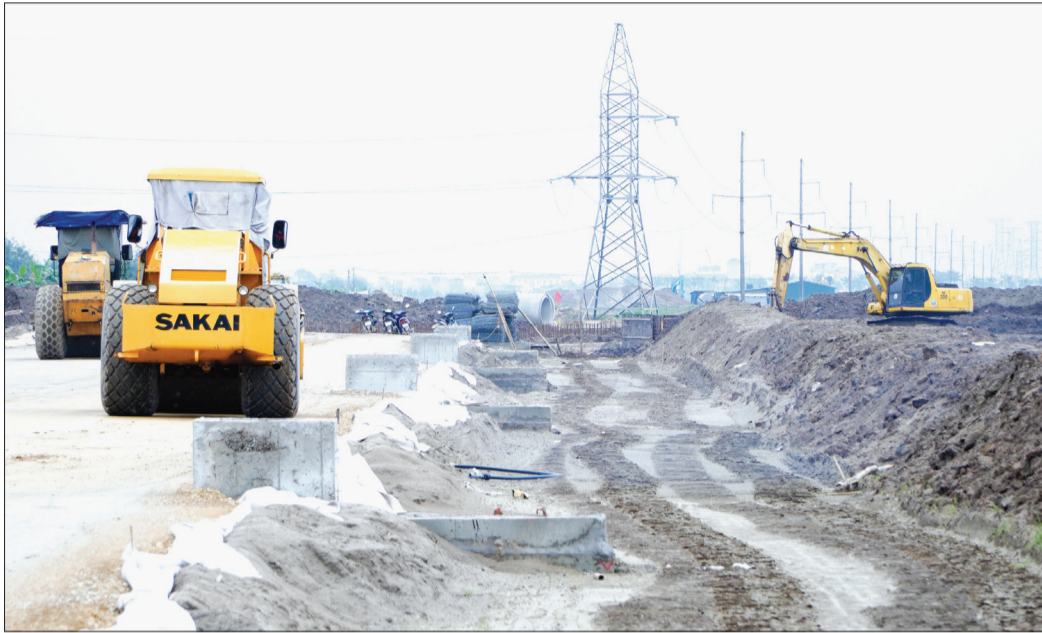
Thi công hạ tầng phục vụ khởi công dự án nhà máy Lotes Thái Thụy Việt Nam tại khu công nghiệp Liên Hà Thái.
