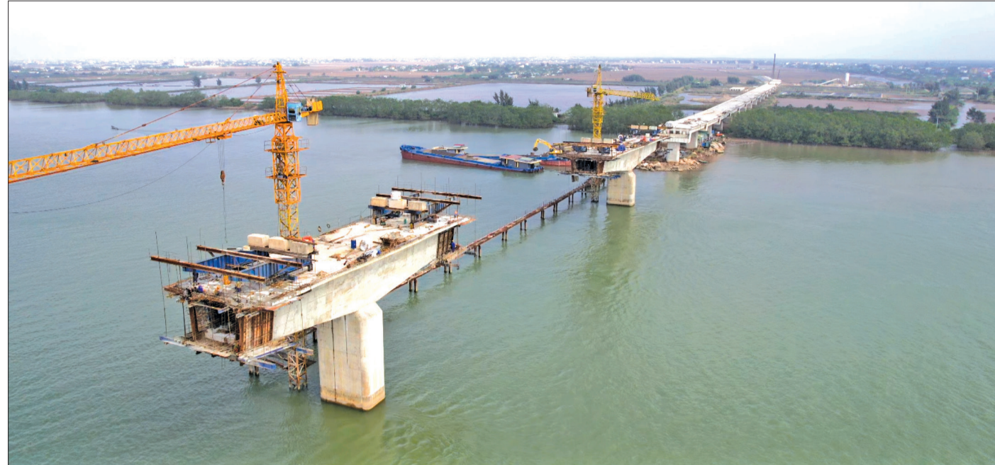
Thi công cầu vượt sông Hồng thuộc dự án đầu tư xây dựng tuyến đường bộ ven biển tỉnh Thái Bình.
