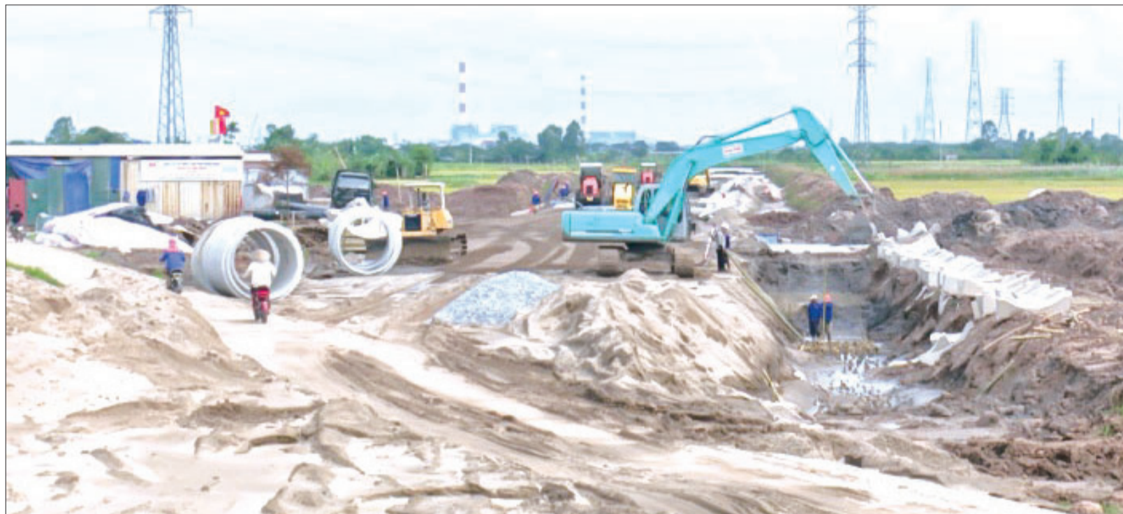
Xây dựng đường giao thông nội bộ trong khu công nghiệp Liên Hà Thái (Thái Thụy).
