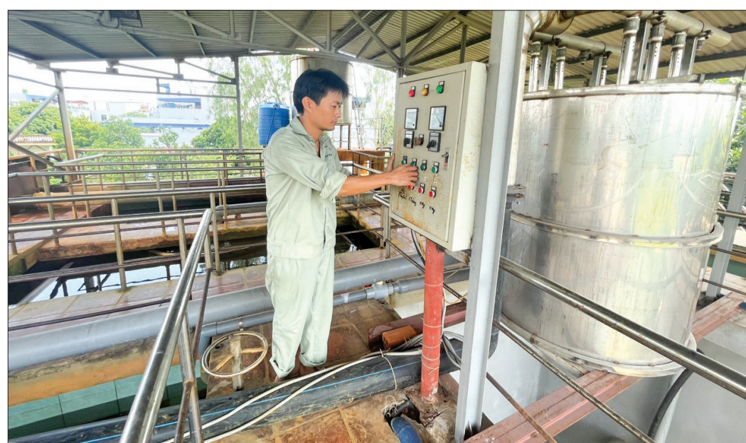
Xí nghiệp nước Hưng Nhân thường xuyên kiểm tra, bảo dưỡng hệ thống máy móc trong quá trình vận hành.
