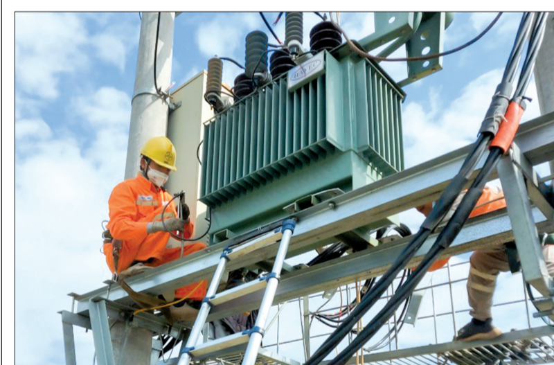
Công nhân Điện lực Đông Hưng bảo dưỡng máy biến áp đáp ứng yêu cầu cung ứng điện trong mùa nắng nóng.
