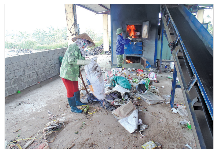
Lò đốt rác thải hoạt động hiệu quả góp phần hạn chế ô nhiễm môi trường trong khu dân cư.
