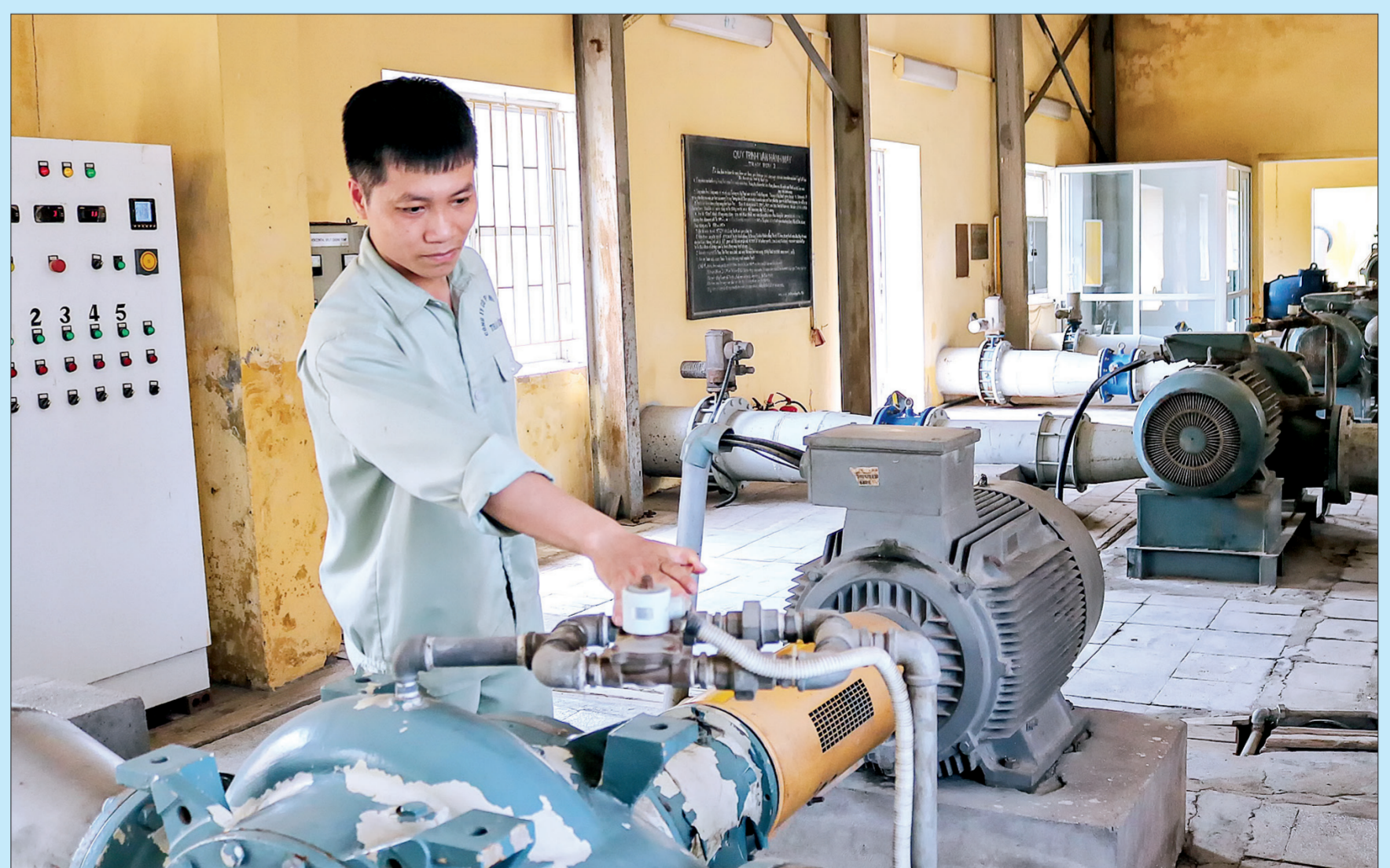
Công nhân Công ty Cổ phần Nước sạch Thái Bình kiểm tra hệ thống máy bơm nước.
