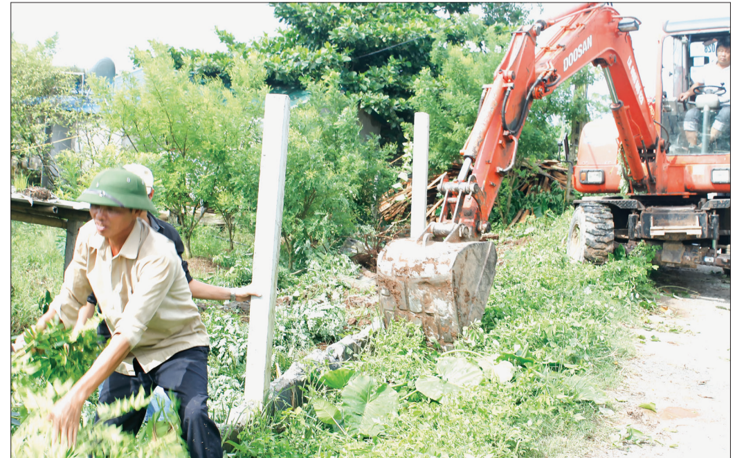
Xã Vũ Tiến (Vũ Thư) tổ chức giải tỏa trường hợp xây dựng công trình vi phạm hành lang bảo vệ an toàn đê điều.
