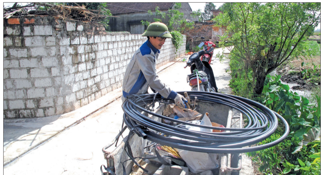
Công ty Cổ phần Kinh doanh nước sạch Mỹ Hưng lắp đặt đường ống và đồng hồ cấp nước cho người dân trong vùng dự án.
