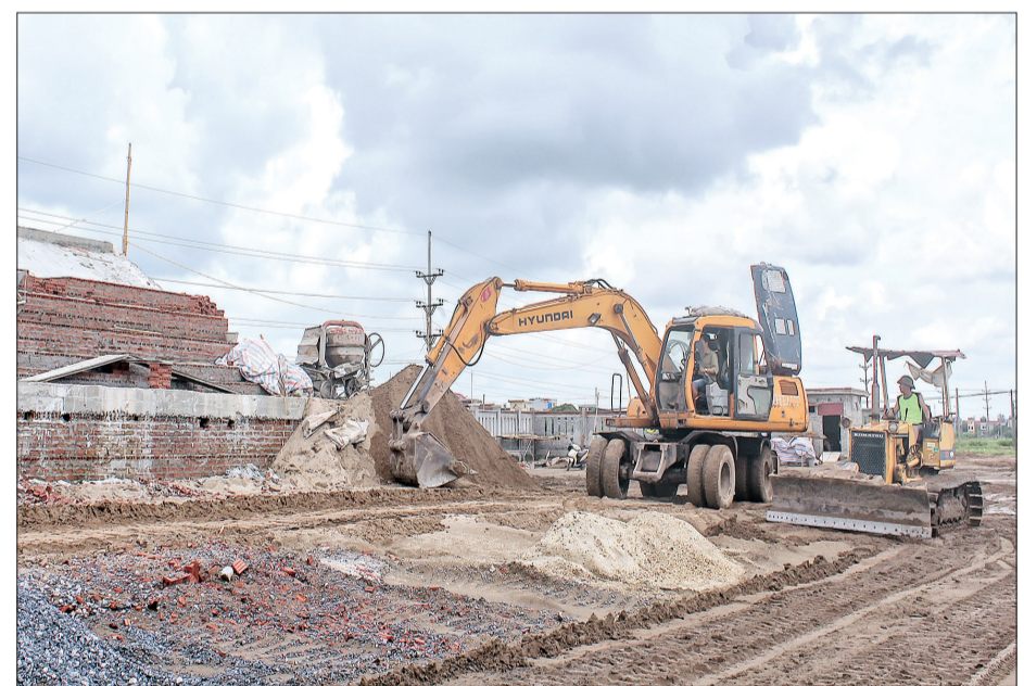
Công ty Cổ phần Xây dựng Thành Đạt thi công sân vận động huyện Đông Hưng.
