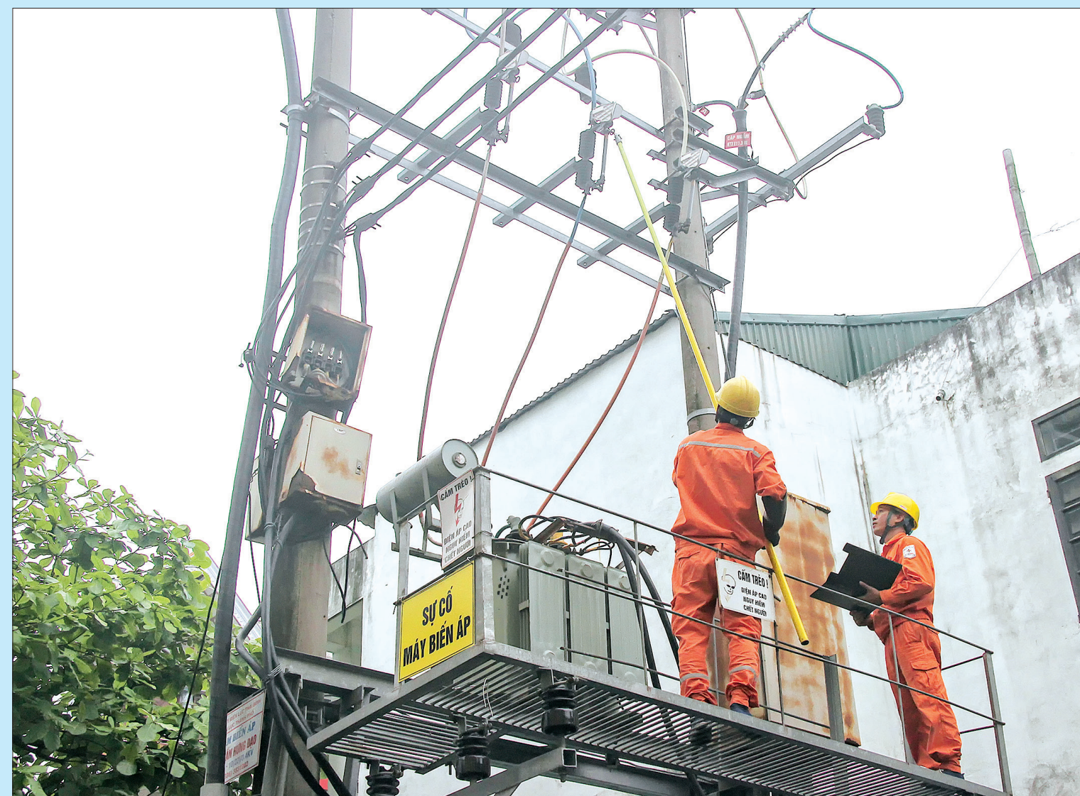
Công nhân Điện lực thành phố Thái Bình kiểm tra trạm biến áp bảo đảm cấp điện an toàn.
