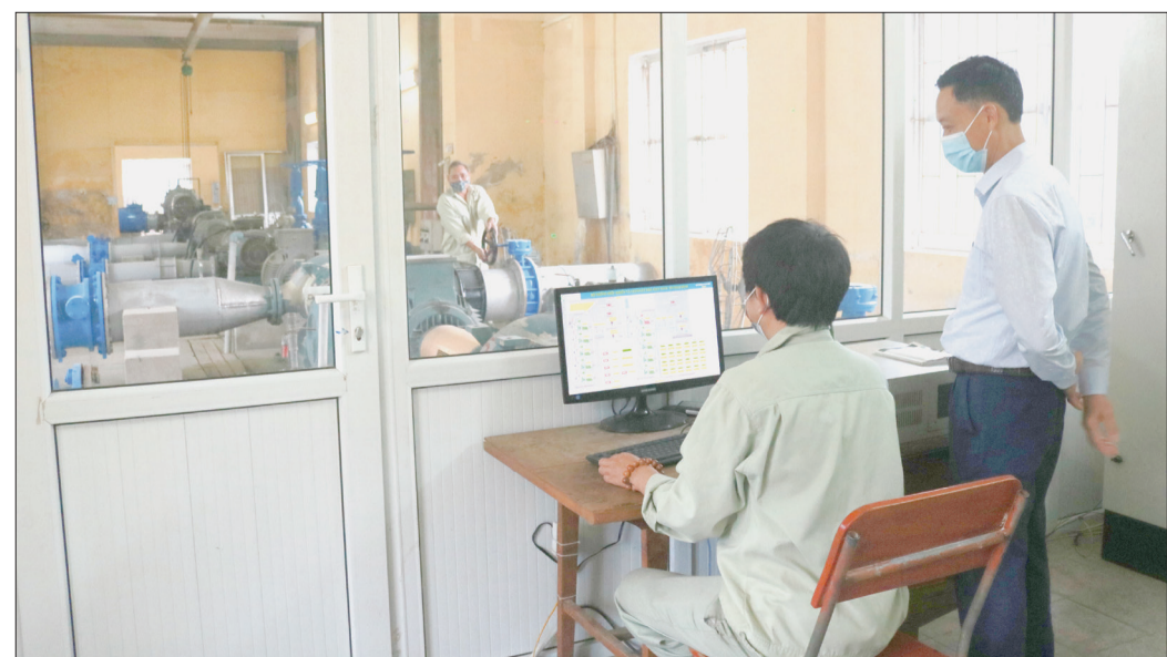
Nhân viên Công ty Cổ phần Nước sạch Thái Bình theo dõi hệ thống cấp nước, quy trình vận hành, sản xuất nước sạch tại nhà máy.
