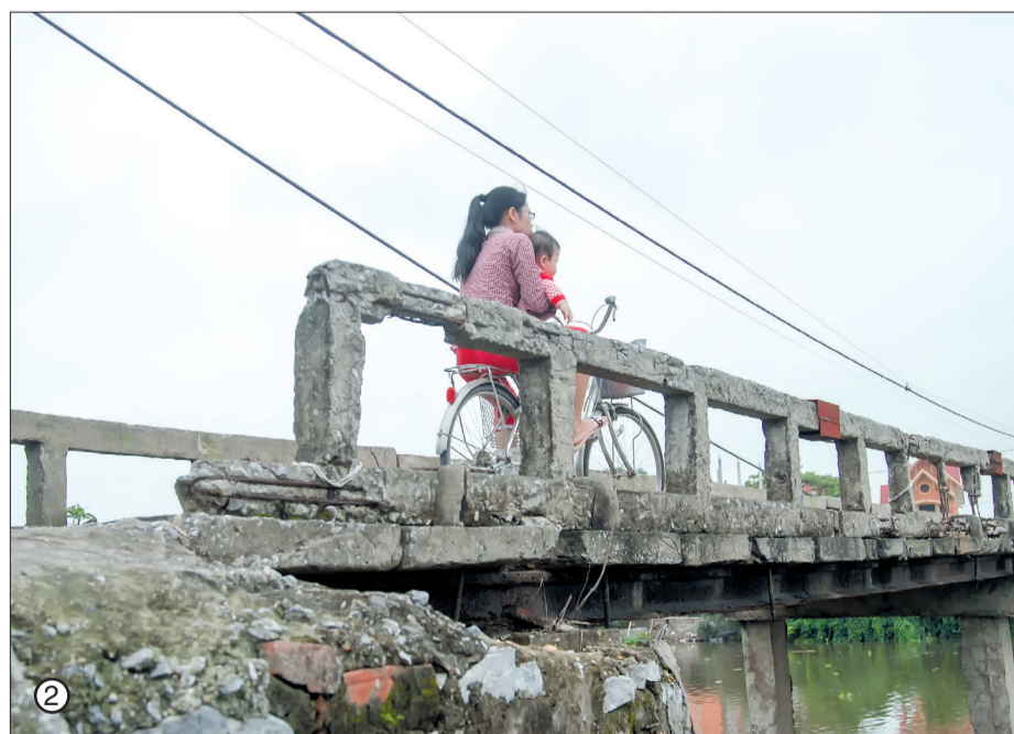
Ảnh 5: Lan can thành cầu cũng xuống cấp nghiêm trọng.
