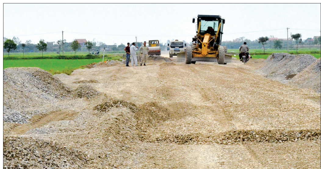
Người dân đồng thuận trong giải phóng mặt bằng, góp phần đẩy nhanh tiến độ thi công các tuyến đường trên địa bàn huyện.
