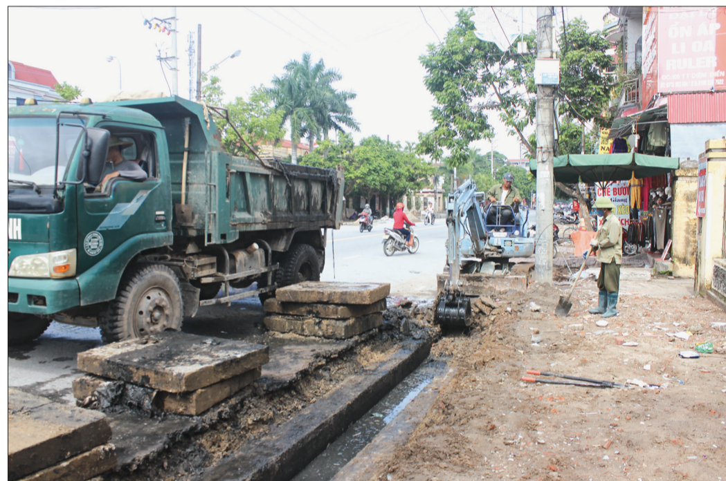
Thị trấn Diêm Điền nâng cấp hệ thống vỉa hè, rãnh thoát nước tuyến đường Nguyễn Đức Cảnh, đoạn từ trung tâm thị trấn đến cống Thốc.
