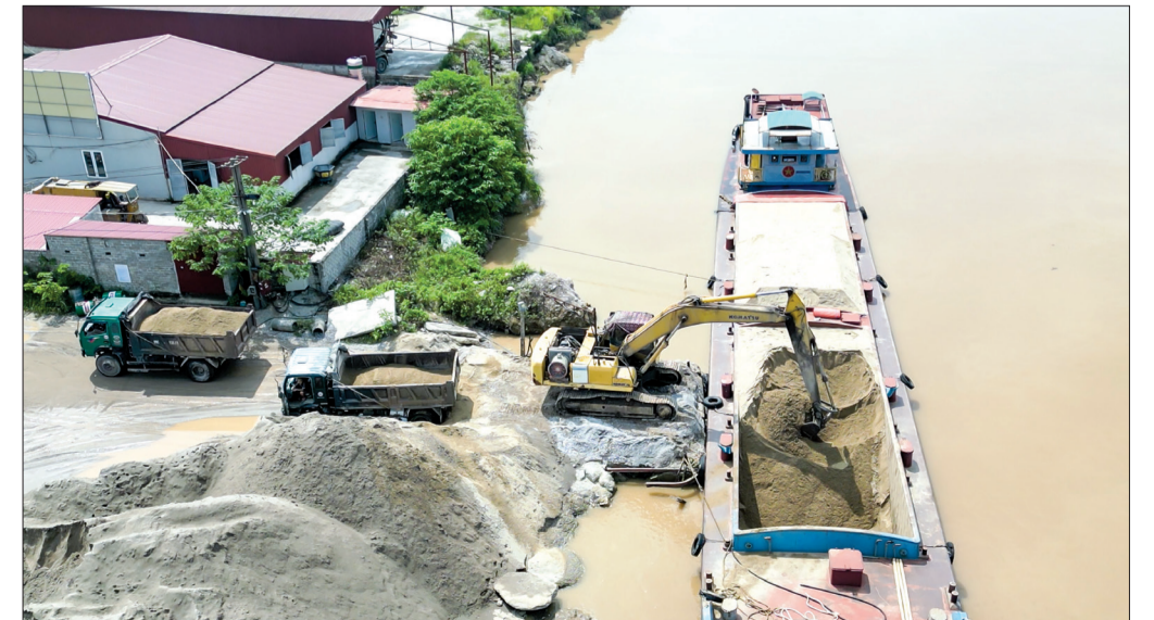
Bến bãi, trạm trộn không phép; nhà xưởng xây dựng kiên cố vi phạm nghiêm trọng hàng lang an toàn đê tả sông Hóa.
