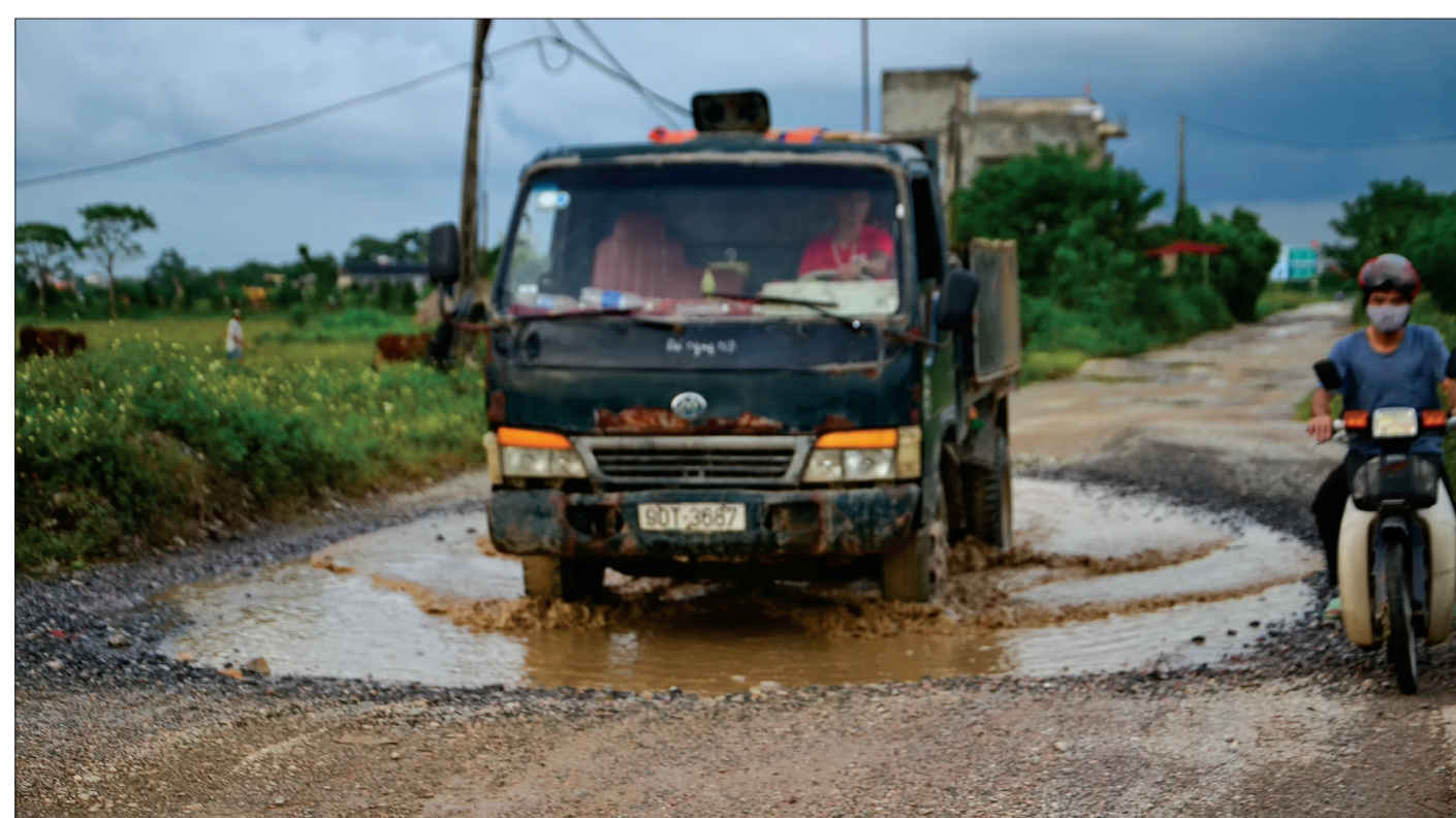
Lớp cấp phối đá dăm bị bong bật tạo ra những ổ gà, ổ voi lớn.
