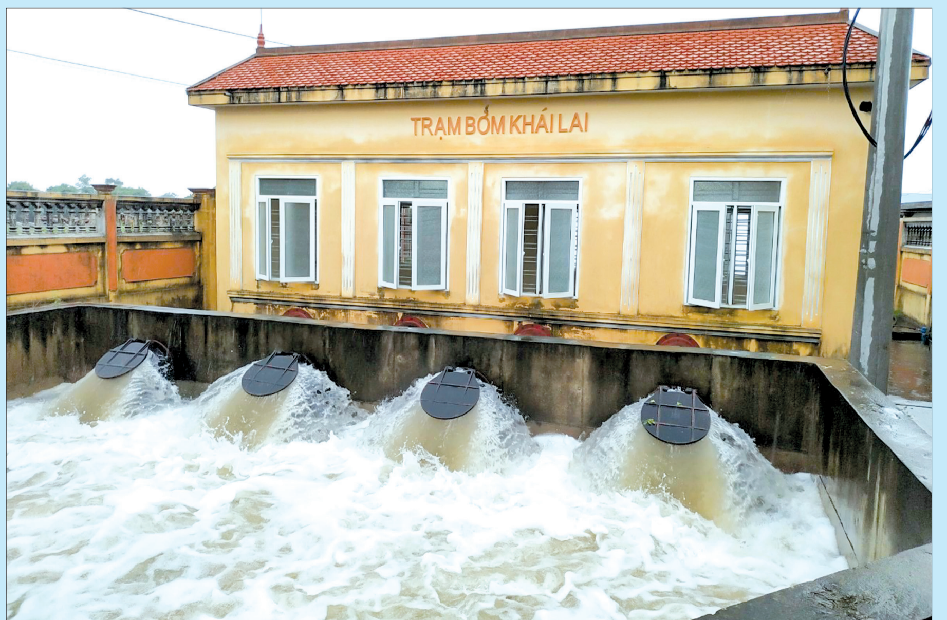
Trạm bơm Khai Lai (Thái Thụy) vận hành bơm tiêu úng.
