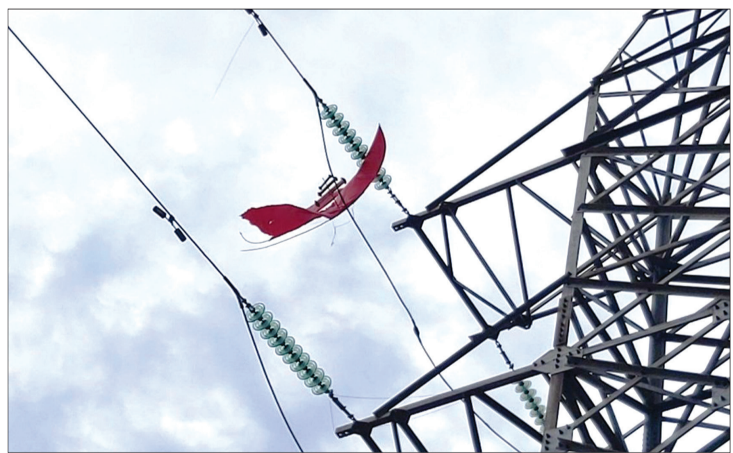
Người dân thả diều vướng vào đường dây tải điện gây mất điện cục bộ.
