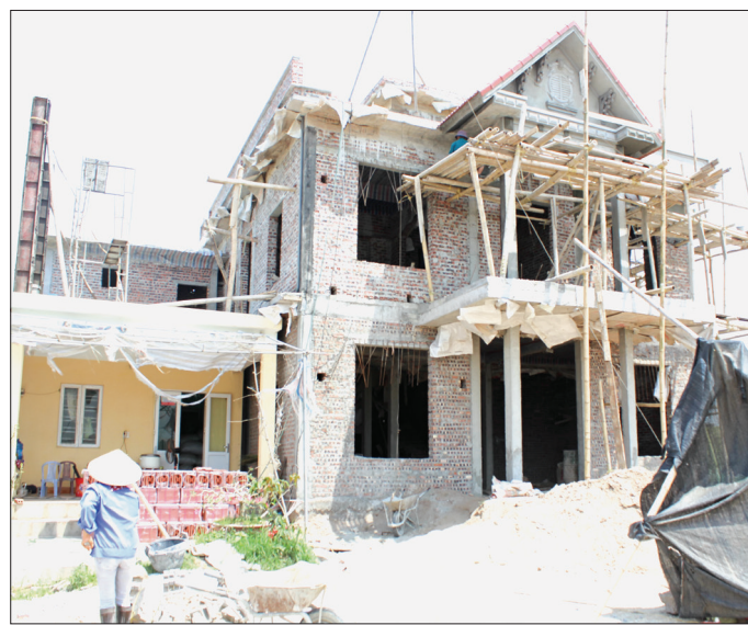
Xây dựng nhà kiên cố trái phép trong hành lang bảo vệ vệ đất tại xã Bạch Đằng (Đông Hưng).
