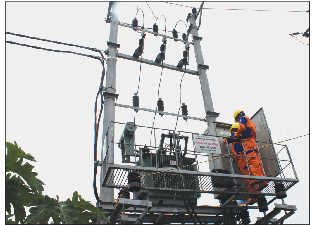
Nhân viên Điện lực Thái Thụy kiểm tra trạm biến áp cung cấp điện cho trạm bơm Khai Lai phục vụ chống úng trong mùa mưa bão.
