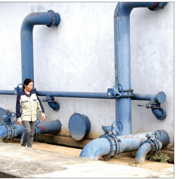
Công nhân Công ty TNHH Một thành viên Kinh doanh nước sạch Thanh Sơn kiểm tra hệ thống cấp nước sạch.
