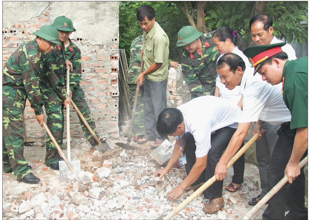
Các cấp, các ngành và lực lượng vũ trang huyện Kiến Xương phối hợp xây dựng nhà tình nghĩa cho đối tượng chính sách.
