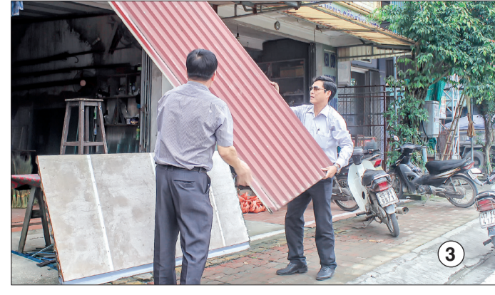
1. Cây xanh che khuất tầm nhìn của người tham gia giao thông được các hộ dân tự tháo dỡ. 2. Một hộ dân ở xã Đông Các tự phá dỡ phần vỉa hè lấn chiếm. 3. Mái tôn vi phạm hành lang an toàn giao thông tại xã Phú Châu được các hộ dân tự tháo dỡ.
