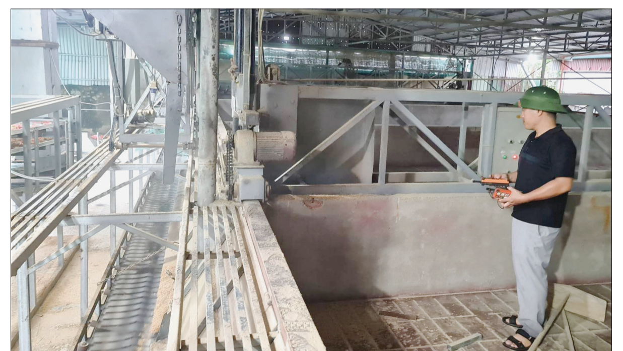
Dây chuyền sấy thóc của Công ty TNHH Lương thực thực phẩm Khang Long công suất 70 tấn thóc tươi/mẻ.
