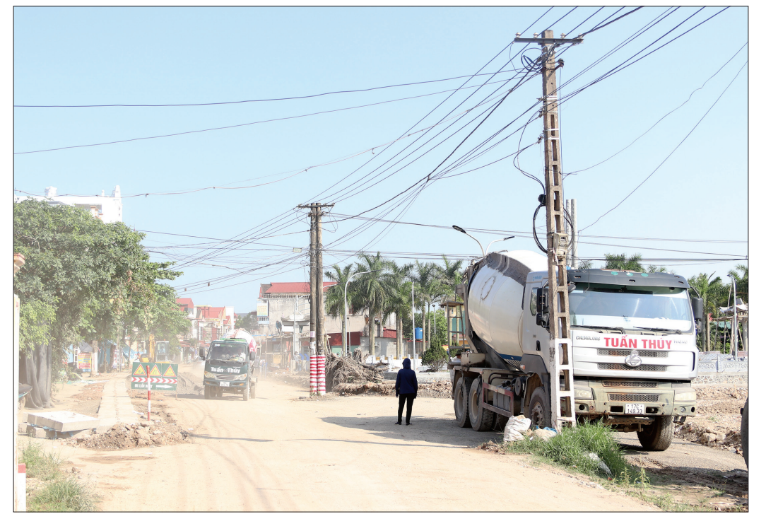
Dự án cải tạo, nâng cấp đường tỉnh 455 đoạn từ xã An Dục, huyện Quỳnh Phụ đến đường tỉnh 456, huyện Thái Thụy còn vướng mặt bằng 60 cột điện.
