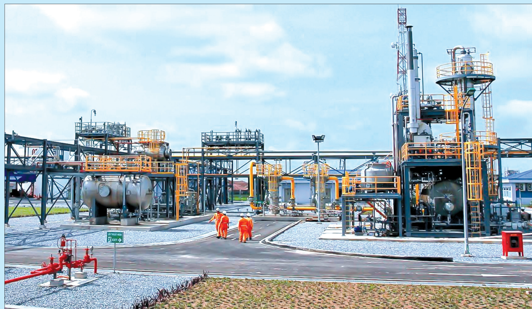
Hệ thống phân phối khí tại khu công nghiệp Tiên Hải.
