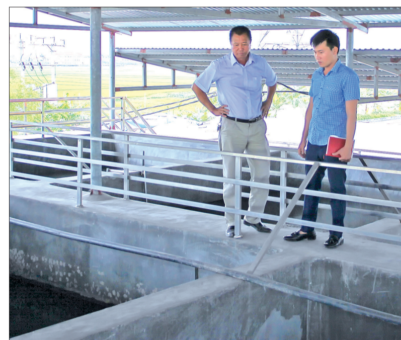
Khu xử lý nước sạch của Công ty TNHH Thương mại Đồ Gia Bảo.
