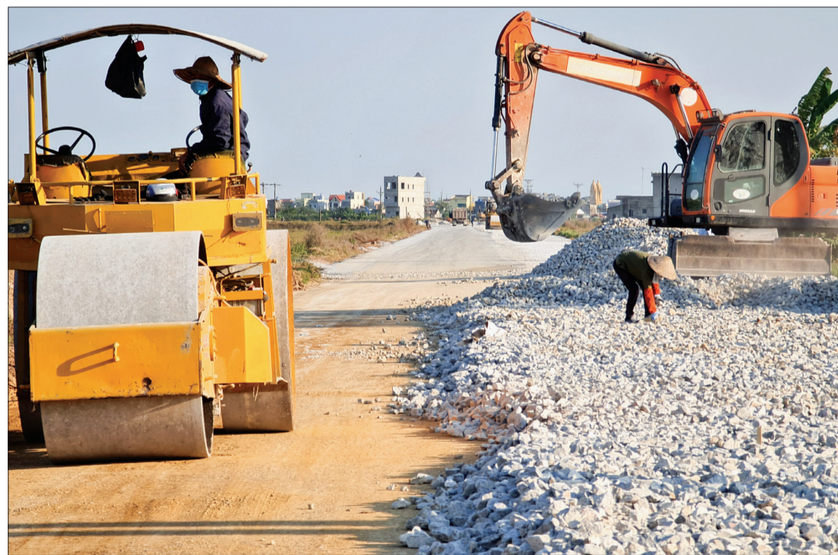
Công ty Cổ phần Tập đoàn Phú Thành huy động nhiều máy móc, phương tiện thi công đường 221A.
