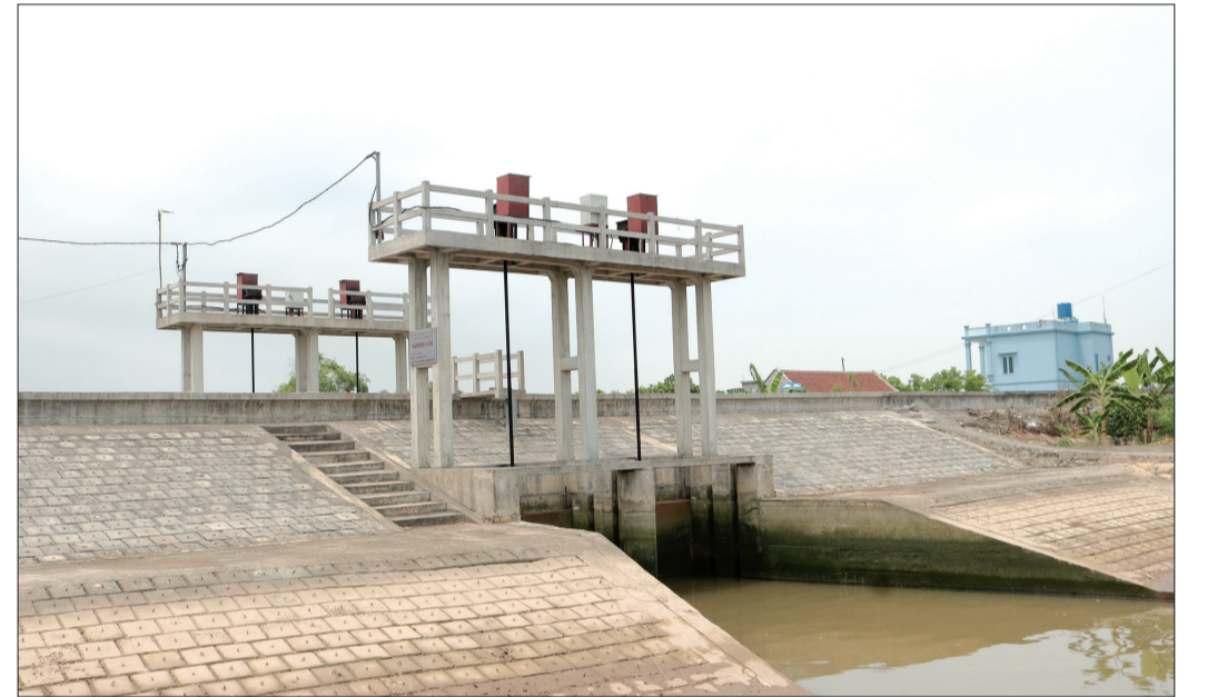
Cống Tiên Đông, xã Đông Trà (Tiên Hải) được đầu tư xây dựng phục vụ công tác phòng, chống lụt, bão.
