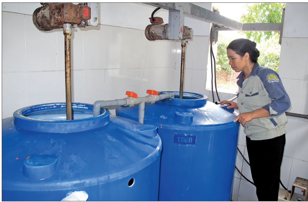
Xử lý hóa chất tại nhà máy nước sạch Quỳnh Giao (Quỳnh Phụ).
