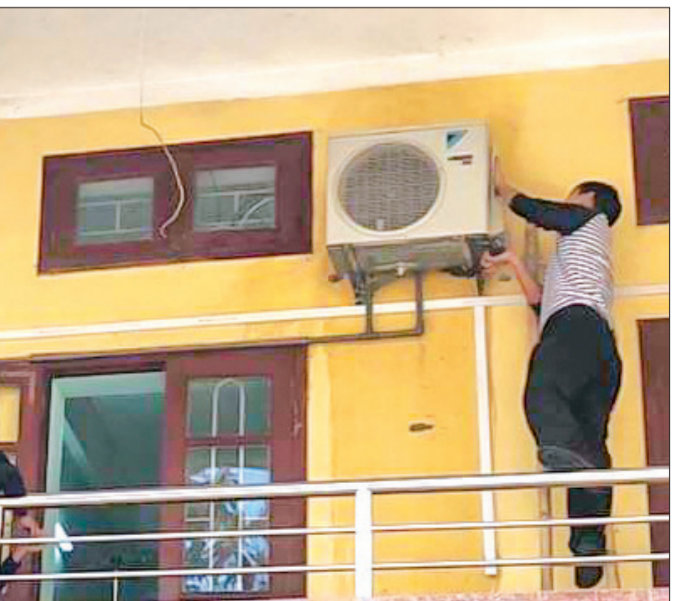
Bảo dưỡng điều hòa các buồng bệnh tại khu nhà D Bệnh viện Đa khoa tỉnh.
