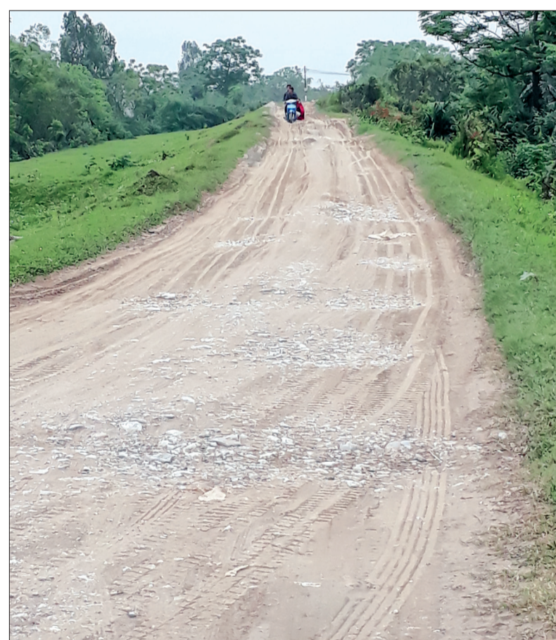
Mặt đường cấp nghiêm trọng.
