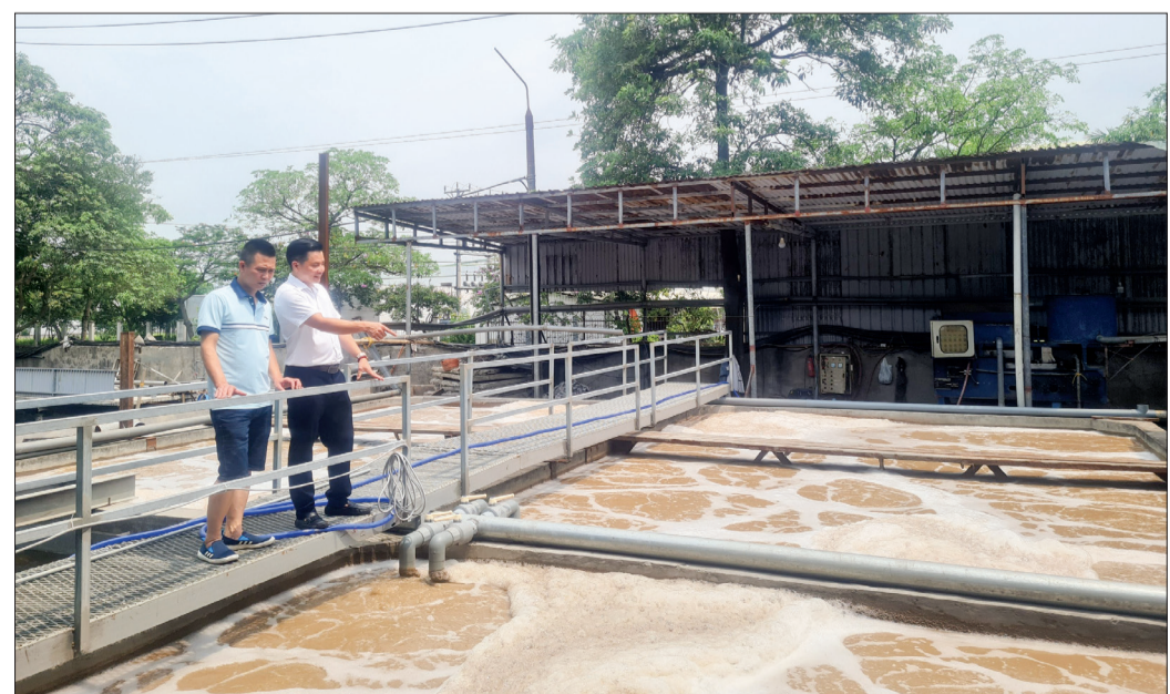
Hệ thống xử lý nước thải của Công ty TNHH Giấy và Bao bì Thái Hiệp Hưng đạt cột B.
