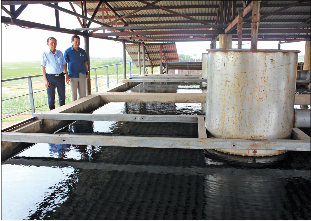
Bể lọc xử lý nước sạch nhà máy nước sạch Nam Chính.
