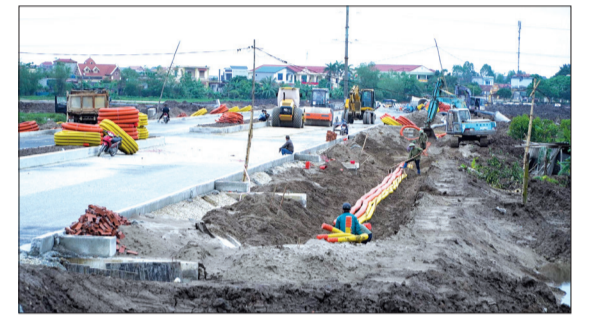
Thi công tuyến đường kết nối từ quốc lộ 39 vào dự án của Công ty TNHH Greenworks Việt Nam, khu công nghiệp Liên Hà Thái.
