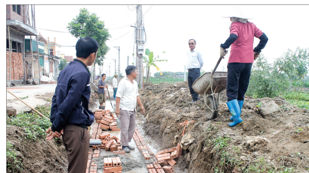
Thôn Huyền Sỹ, xã Minh Quang đầu tư mở rộng mặt đường và xây dựng hệ thống thoát nước tại tuyến đường trục thôn.
