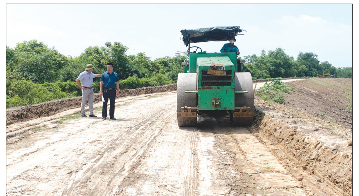
Công trình tu bổ, nâng cấp đê hữu Trà Lý, đoạn từ Km7+00 đến Km7+700, tại địa phận xã Hiệp Hòa (Vũ Thư) hoàn thành 40% khối lượng.
