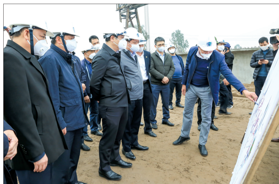
Các đồng chí: Ngô Đông Hải, Ủy viên Ban Chấp hành Trung ương Đảng, Bí thư Tỉnh ủy; Nguyễn Khắc Thiện, Phó Bí thư Tỉnh ủy, Chủ tịch UBND tỉnh kiểm tra tiến độ thi công tuyến đường bộ ven biển địa phận huyện Thái Thụy.
