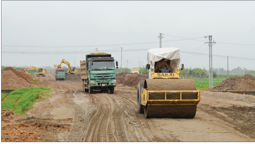
Thi công tuyến đường bộ ven biển đoạn qua huyện Thái Thụy.
