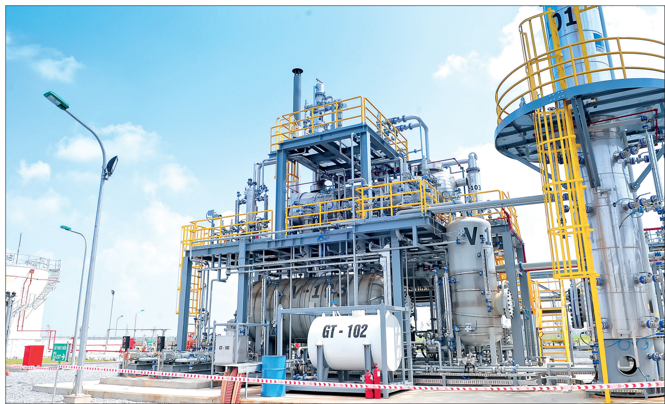
Hệ thống thu gom và phân phối khí mỏ Hàm Rồng và mỏ Thái Bình lò 102 & 106 giai đoạn 1.
