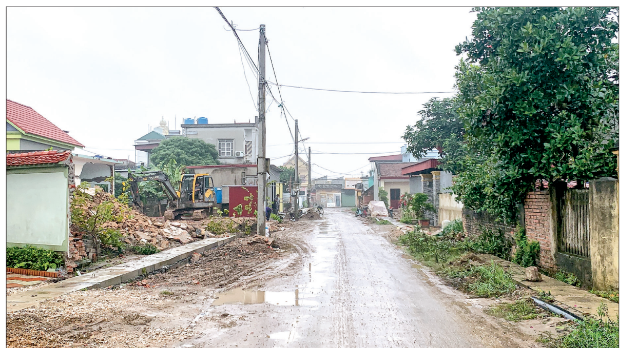
Cột điện nằm dưới lòng đường nên nhiều vị trí không thi công được nền đường, rãnh thoát nước.
