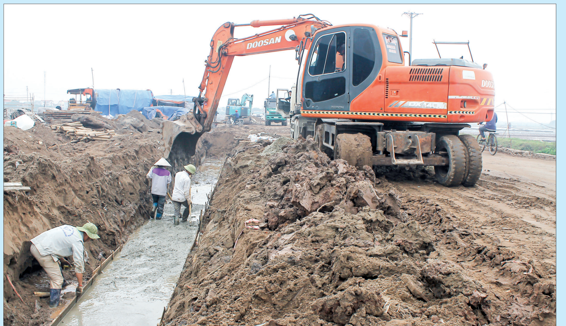
Thi công tuyến đường cứu hộ, cứu nạn qua địa bàn xã Tân Phong (Vũ Thư).
