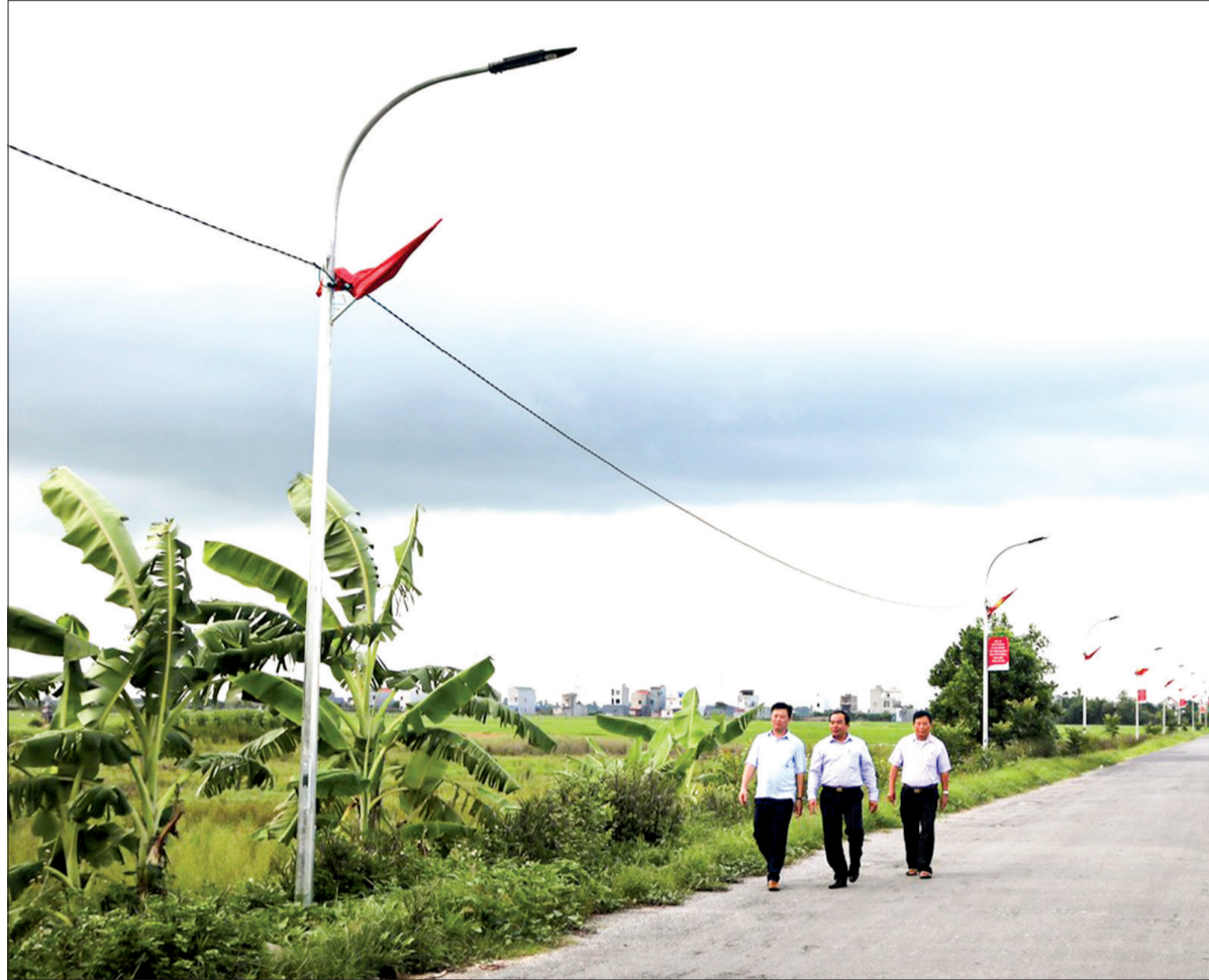
Hệ thống đường điện “Thắp sáng đường quê” tại xã Dũng Nghĩa (Vũ Thư).
