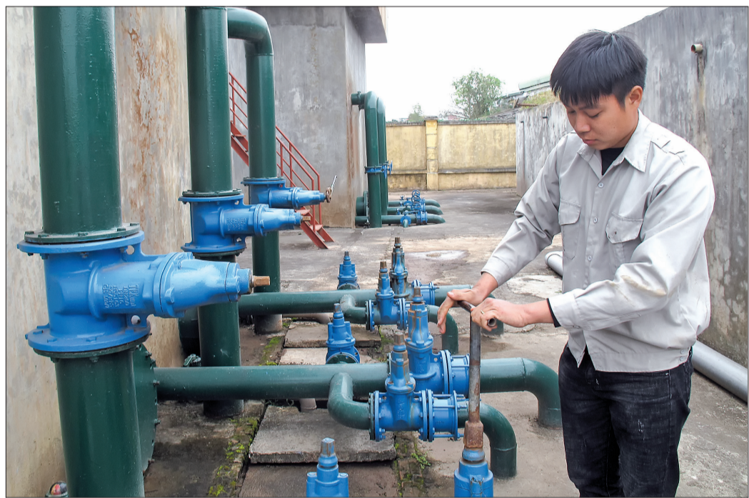
Công nhân vận hành nhà máy nước sạch liên xã Thượng Hiền (Kiến Xương).
