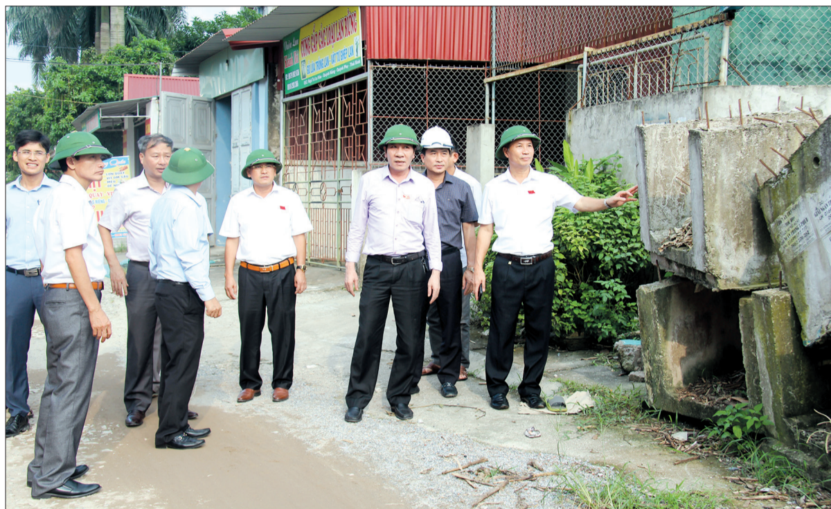
Lãnh đạo HĐND tỉnh khảo sát thực địa thi công đường ĐH.72 chạy qua địa phận huyện Quỳnh Phụ.
